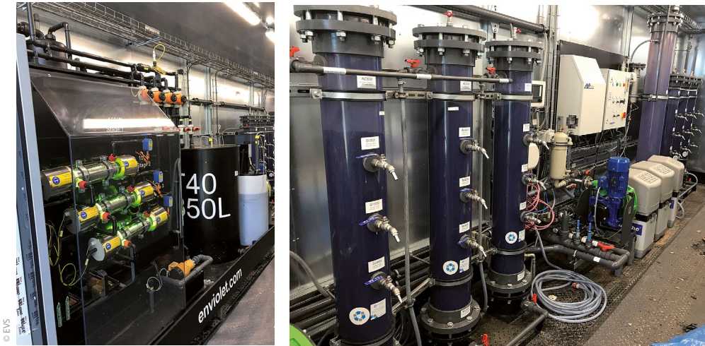
Bild 5: Innenansicht der Demonstrationsanlage; links im Vordergrund die Photo-Fenton-Anlage der Linie 2, rechts im Vordergrund die Säulen der Linie 3, im Hintergrund Ozonung und Säulen der Linie 4
