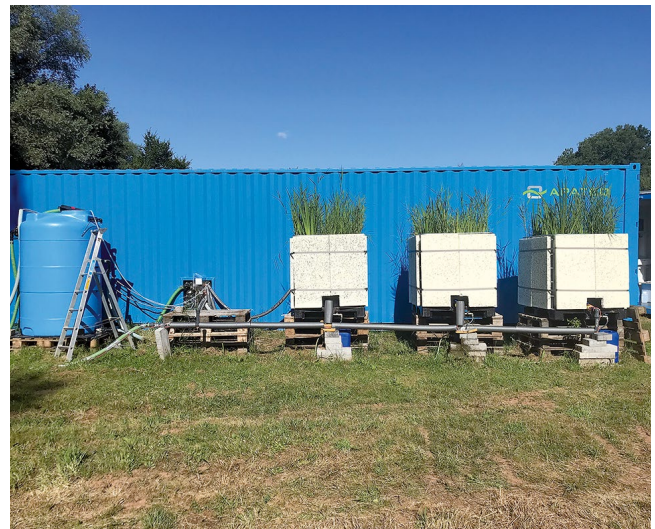
Bild 4: Außenansicht der Demonstrationsanlage mit den bepflanzten Bodenfiltern der Linien 1 und 2
